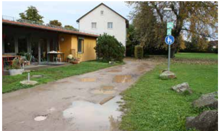
Viele Schlaglöcher machten es unmöglich den Weg mit einem Rollstuhl zu befahren
